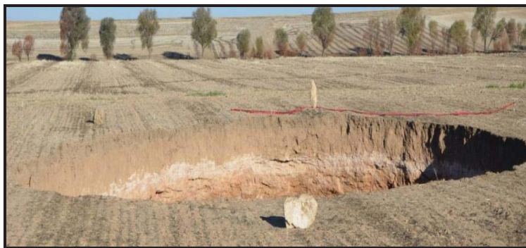
Figure 12. Kadınhanı Hançerli Sinkhole
